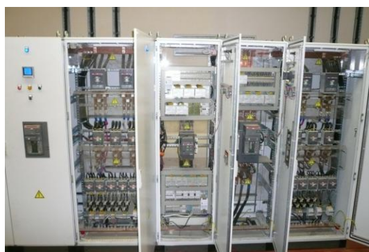
Рис. 1. Распределительное устройство низкого напряжения РТП-34 НИУ "МЭИ" с трансформаторами тока и контроллерами качества электрической энергии.
